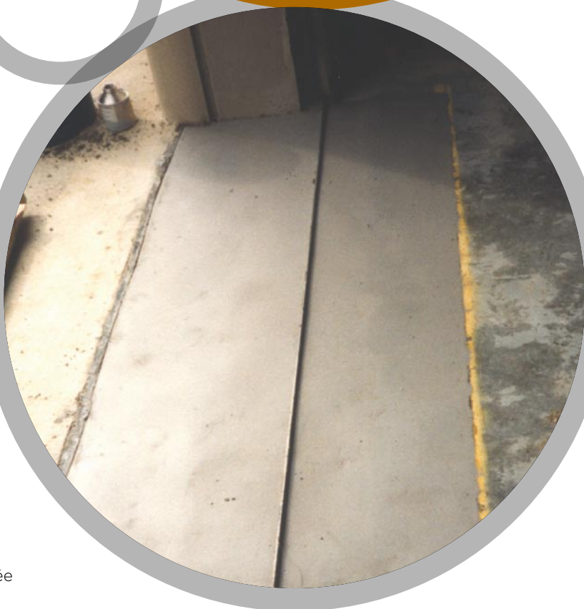
Surfaces au sol à problèmes
